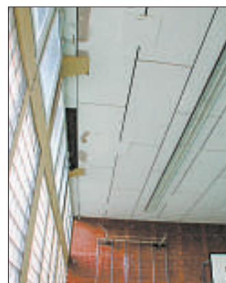
Wasserschaden: Das Dach der kleinen Turnhalle muss erneuert werden.
