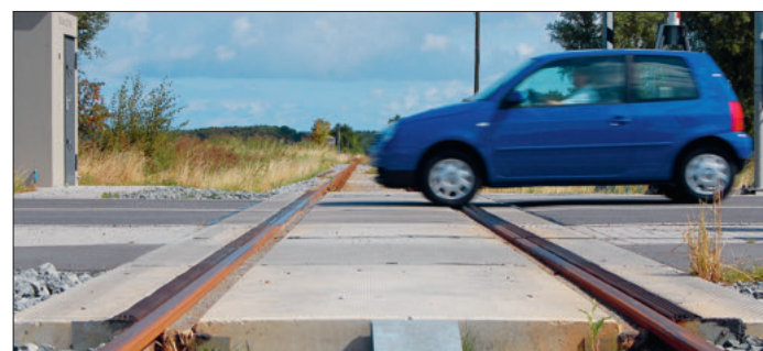
Ein Grund für die Geräusche könnte sein, dass die Schienen über den Betonträger hinausragen. Daher wurden bereits Gummistücke eingebaut. „Wir sind aber mit den kleineren Maßnahmen am Ende“, will Behördenchef Frank Buchholz nun Fakten schaffen.
