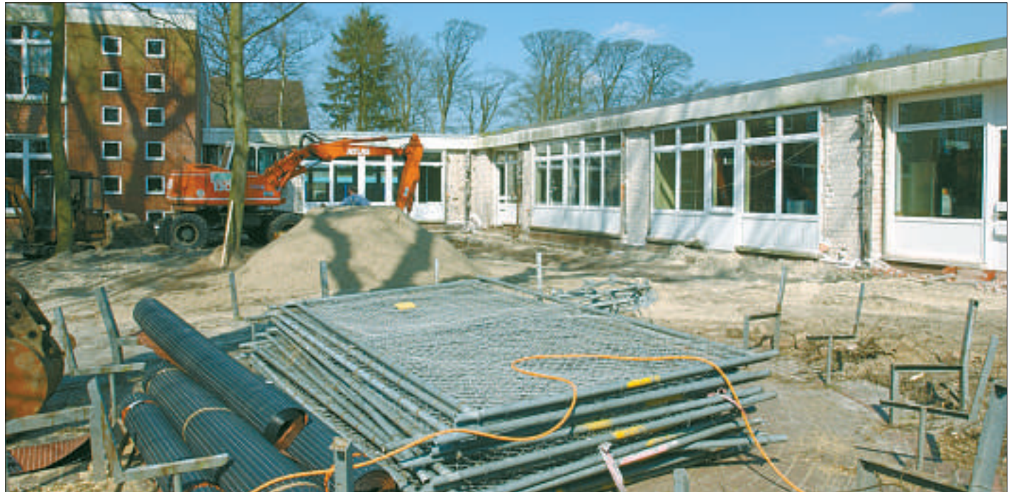
Die Umbauarbeiten an der KGS haben begonnen. Am Ende sind weit über vier Millionen Euro investiert worden.
